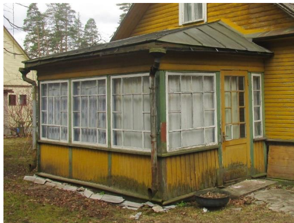
189. Vihmaveetorud veranda välisnurgades ja amortiseerunud vihmaveerennid. Veranda seintel tugevad niiskuskahjustused.
