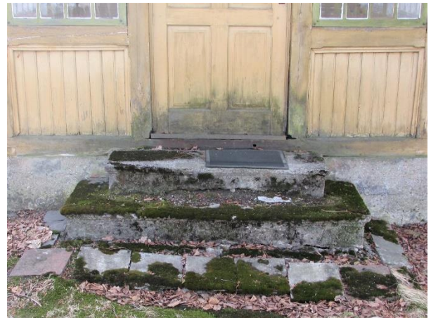
187. Ukse ja trepi kahjustused.
