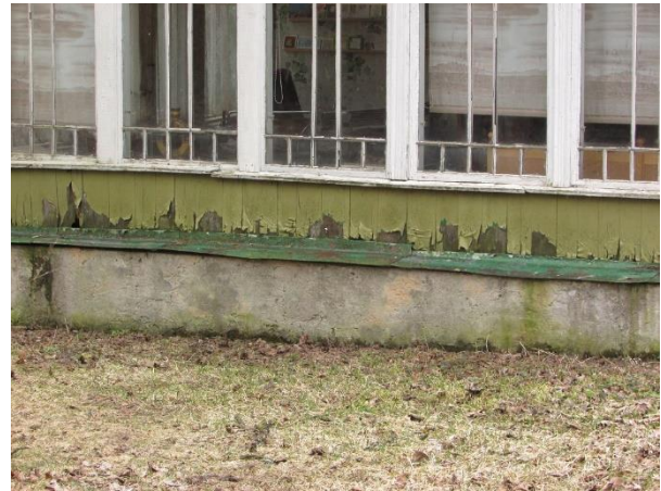
183. Nõmmel Hiiu-Maleva 29. Vale värvi kasutamine ja valesti paigaldatud veeplekist tulenevad kahjustused veranda seinas allosas.
