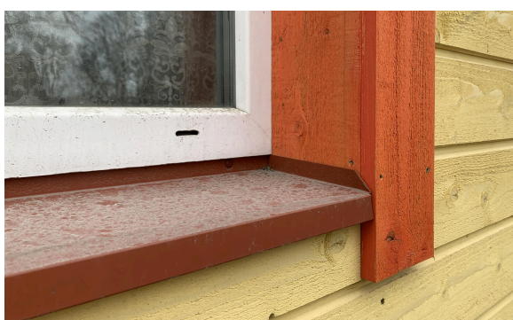
78. Piirdeliistu ja aknapleki sõlm ebakorrektselt lahendatud, Pikk 29 aastal 2024.
