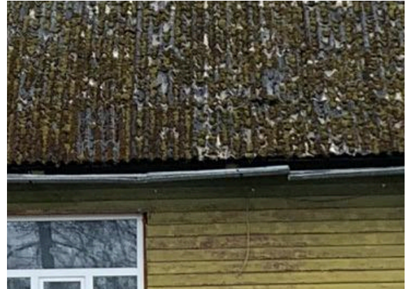
123. Ripprenn, mis on kinnitatud fassaadi külge ja on katki läinud. Pikk 33, Järva-Jaani, 2023.
